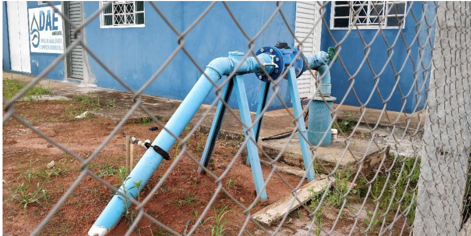
Figura 6. Poço Artesiano PT-05
